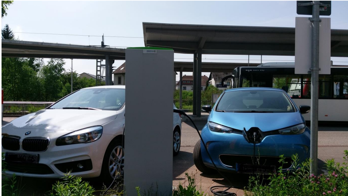
Abbildung 31 Ladestation für Elektroautos (Quelle: Eigene Darstellung, DSK, 2018)
