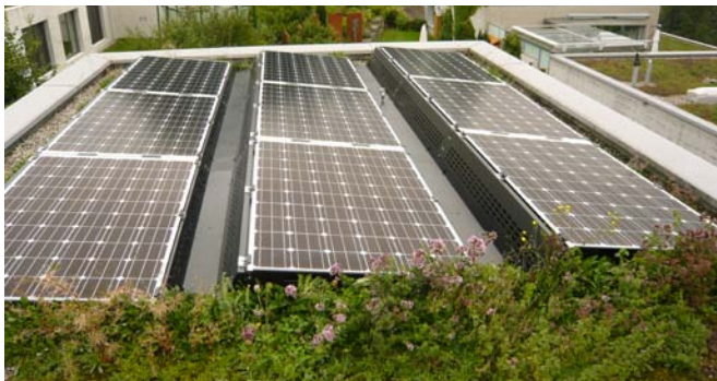
PV-Anlage in Kombination mit intensiver Dachbegrünung.
