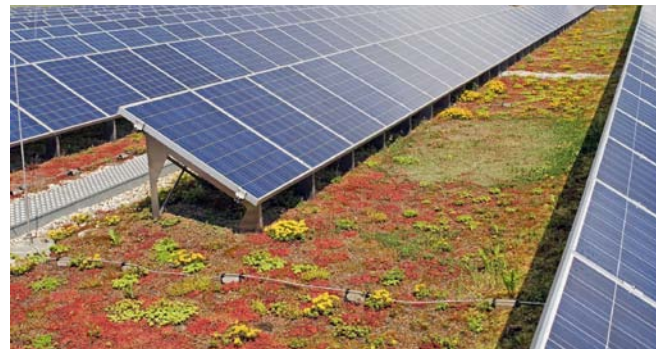
PV-Anlage in Kombination mit extensiver Dachbegrünung.
